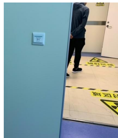
迷道内机房门旁紧急开门按钮
